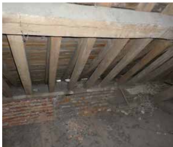
Encuvement en maçonneries de briques remanié et lacunaire, la sablière de chevrons ne s'appuie plus entièrement sur l'arase.
