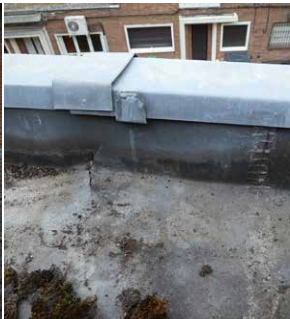
Les chéneaux des gouttereaux des bas-côtés sont en très mauvais état, les soudures craquent et des déformations ont percé les feuilles de zinc.
