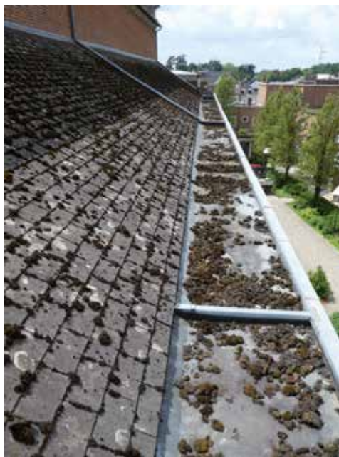
La couverture du bas-côté Nord est colonisée par les mousses, les chéneaux sont encombrés.
